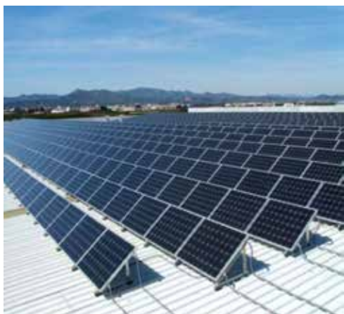
Figura N° 1: Parque Solar Fotovoltaico. Pozo Almonte. Región de Tarapacá.
