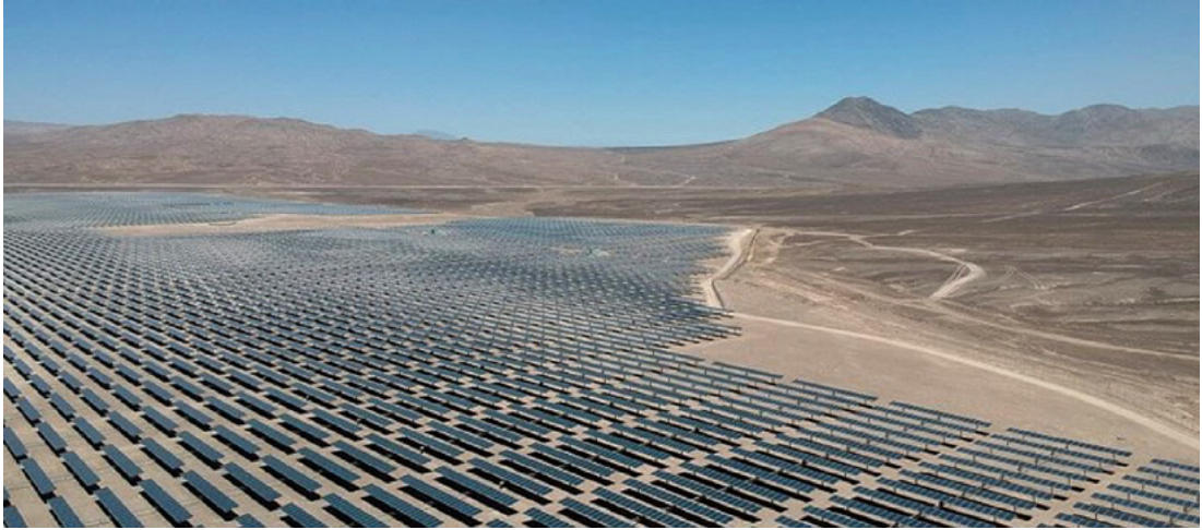
Figura Nº 4: Planta solar fotovoltaica Bolero, Región de Atacama, Chile.
